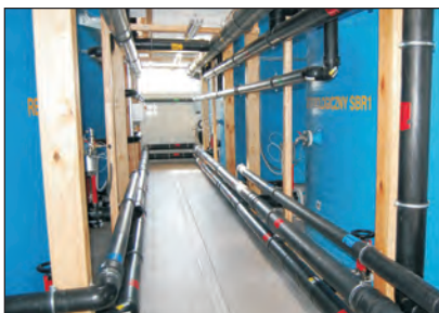
Oczyszczalnia ścieków w Chodaczowie.
