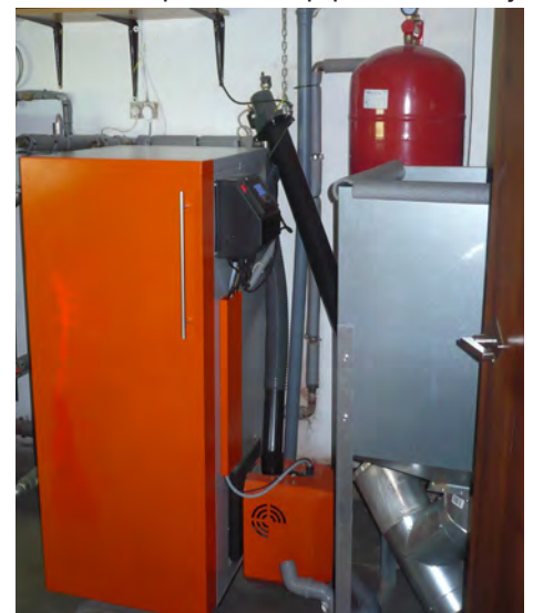
Fot.2. Kotłownia z kotłem na pellet drzewny
