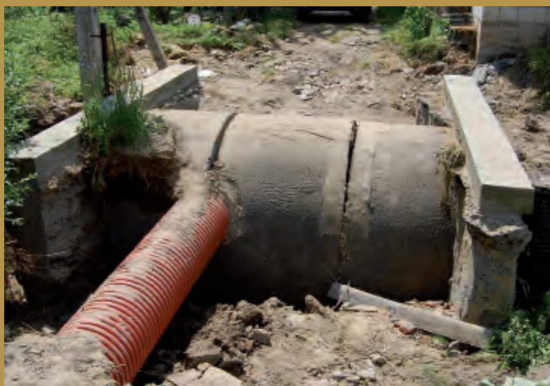
Zniszczony dojazd do gospodarstwa
