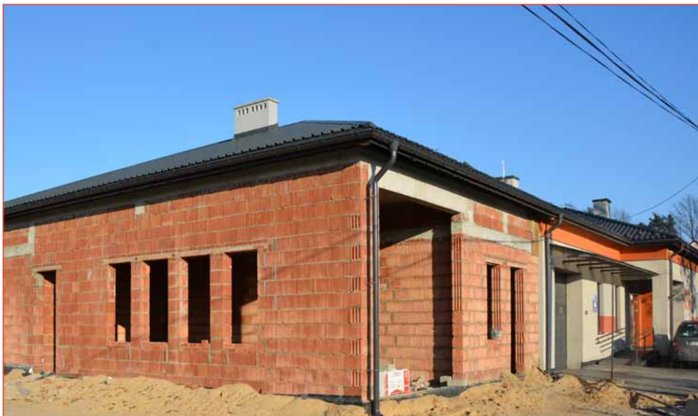
W Środowiskowym Domu Samopomocy w Laszczynach planowana jest m.in. nowa sala ogólna umożliwiająca spotkania integracyjne uczestników i ich rodzin, rozbudowa sali rehabilitacyjnej i jadalni, wykonanie dwóch nowych pomieszczeń gospodarczych oraz wybudowanie trzech garaży i dodatkowej toalety dla osób niepełnosprawnych. Nowe pomieszczenia zostaną odpowiednio wyposażone
